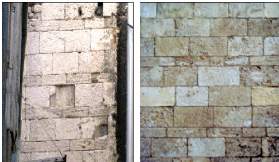
Fig. 1 «Appareil de Montpellier» : L'appareil alternant assises de parpaings traversants et de carreaux posés sur chant
