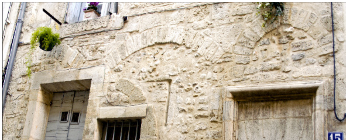
Fig. 22 15, rue de l'École de Pharmacie — arcs de décharge d'anciennes baies sous linteau de bois
